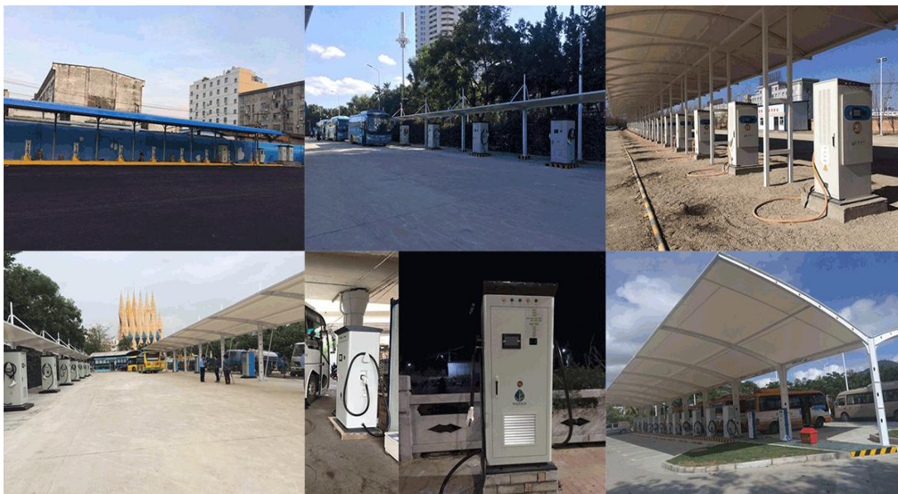
图 4-2 位于室外的直流快充桩
